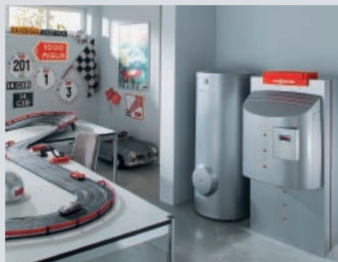
Chaudière gaz à condensation au sol Vitocrossal 300 associée à un ballon d'eau chaude Vitocell-V 300
